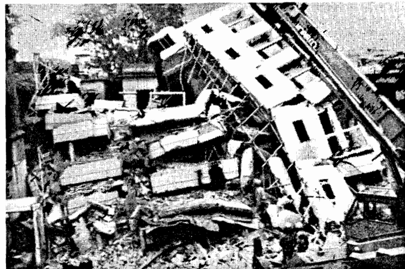
Bergungsmannschaften suchen in den Trümmern dieses Hauses, das in der Nacht zum Montag in Kalkutta eingestürzt war, nach weiteren Opfern.
